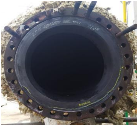
Gambar 3. Seat Gasket yang rusak
