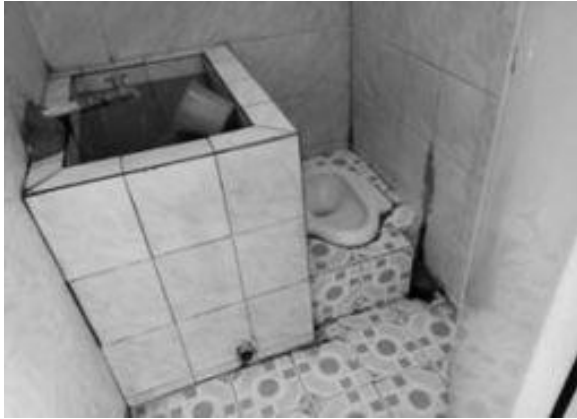
Gambar 11. Bak Air dan Kloset Kamar Mandi/WC di Masjid Raya At Taqwa Sumber : Peneliti, 2014
