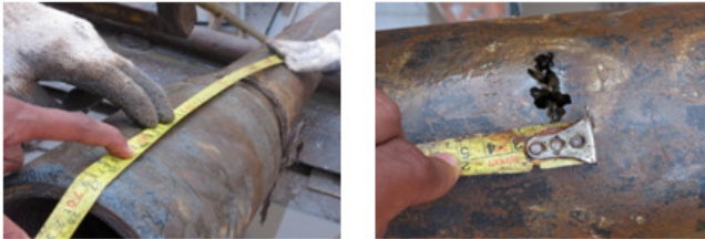
Gambar 1. Lokasi patahan pipa bor di Rig PDSI D1500/53
